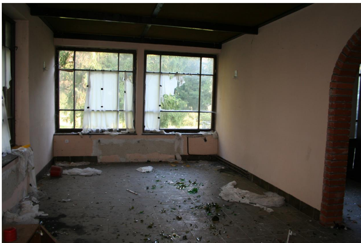
Slika 45: Devastirana notranjost restavracije. (Vir: Lastna zbirka 2019)
