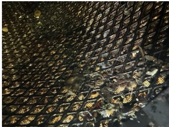
Slika 2: Notranjost 800 \mu\text{m} filtra na cevovodu tehnološke vode.
