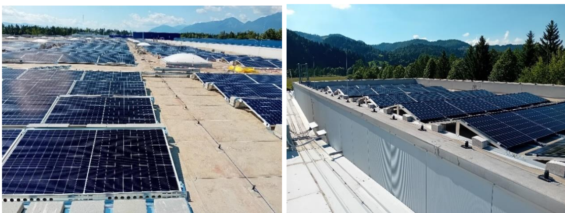
Sliki 12 in 13: Sončna elektrarna, obtežena z betonskimi bloki (lastni vir)
