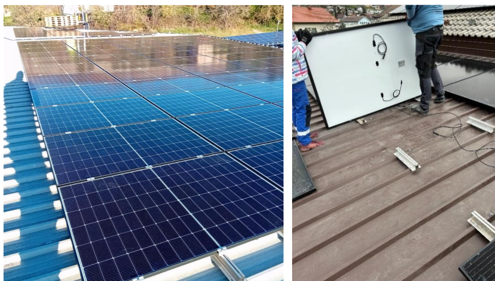
Sliki 8 in 9: Sončne elektrarne na pločevinasti kritini (lastni vir)
