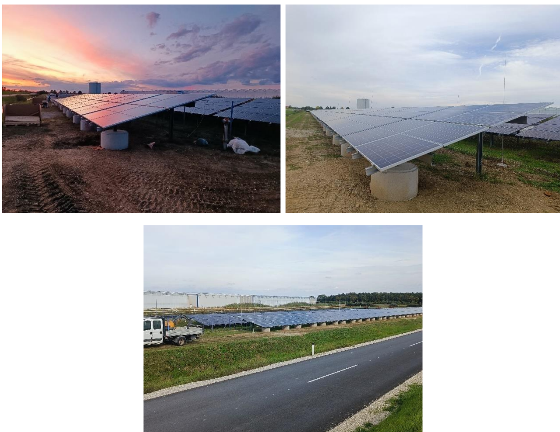
Slika 24, 26 in 27: Sončna elektrarna na betonskih in zabitih temeljih (lastni vir)
