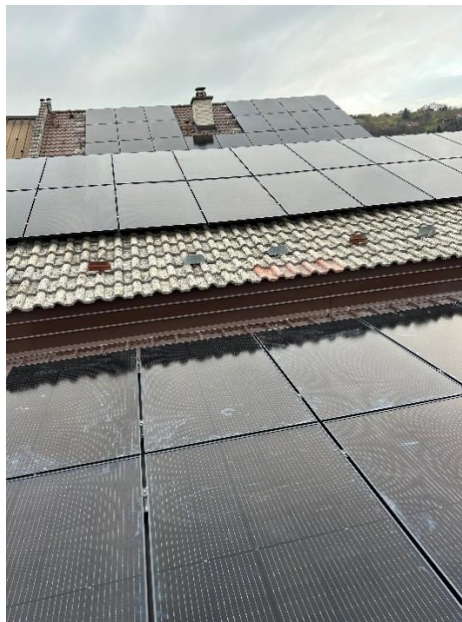
Slika 5: Sončne elektrarne na opečnati in pločevinasti kritini (lastni vir)
