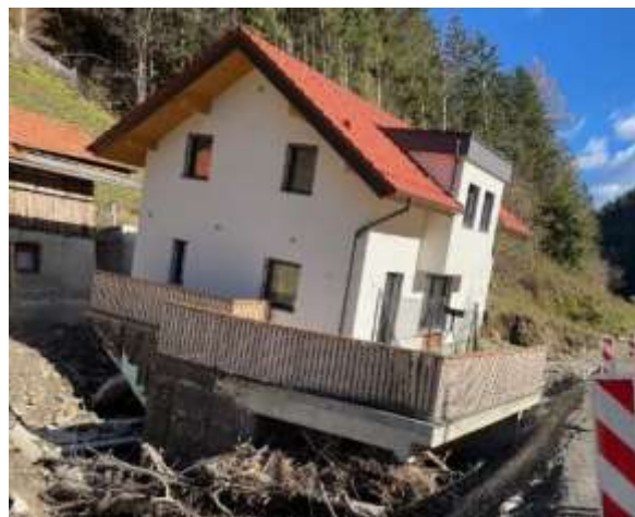
Slika 45: Uničena novogradnja v Strugah 83
