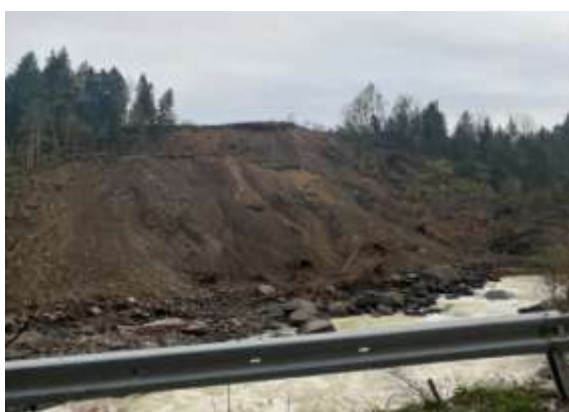
Slika 50: Večji plaz v Strugah 88
