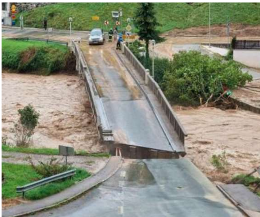
Slika 37: Porušen most v Stahovici (vir: Medmrežje 25)
