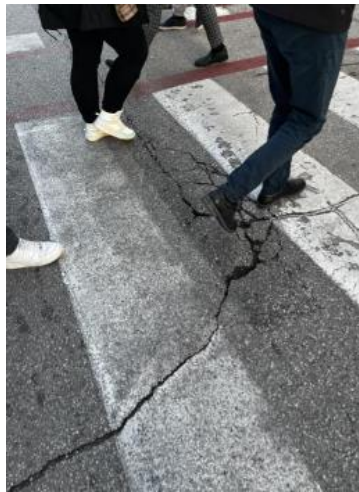
Slika 14: Razpokan pod v mestnem centru. Vir: Lasten
