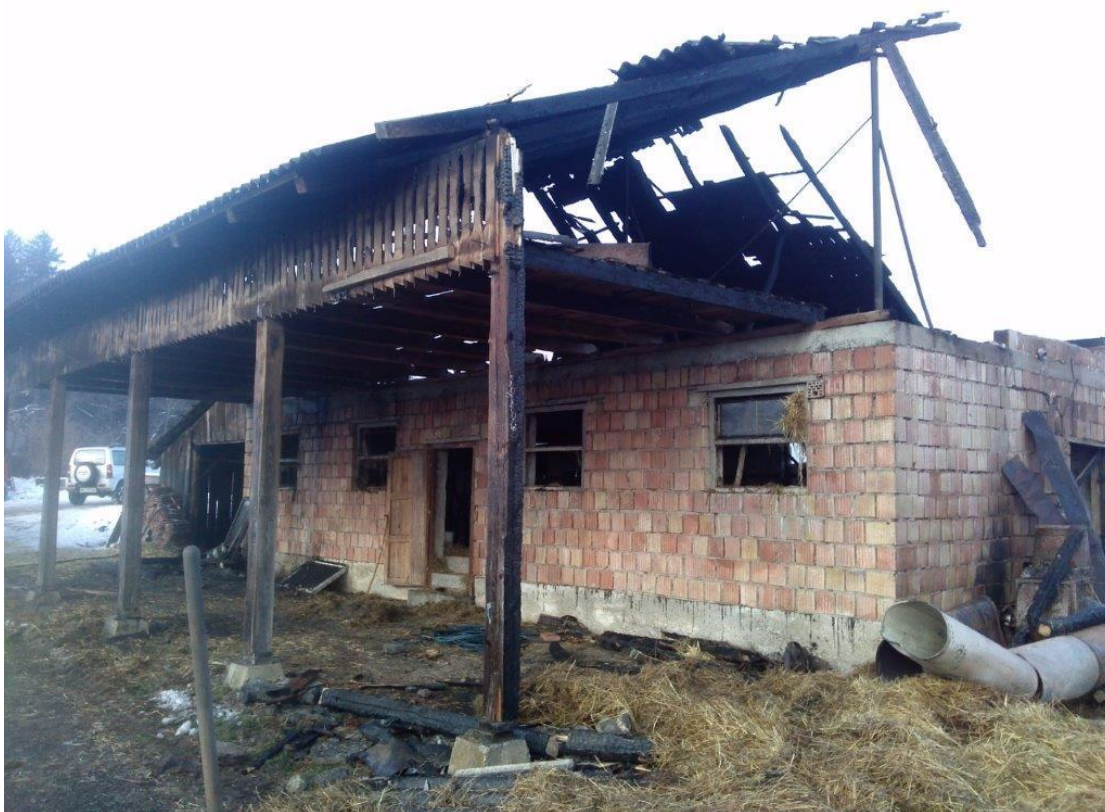
Slika 44: Posledice požara na gospodarskem poslopu. Intervencija gasilcev. (APGD)
