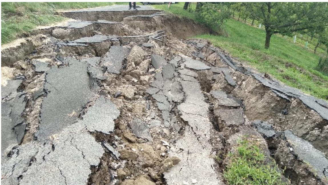
Fotografija 32: Hudo uničena cesta, Špičnik, foto: občinska uprava Kungota, julij 2023.
