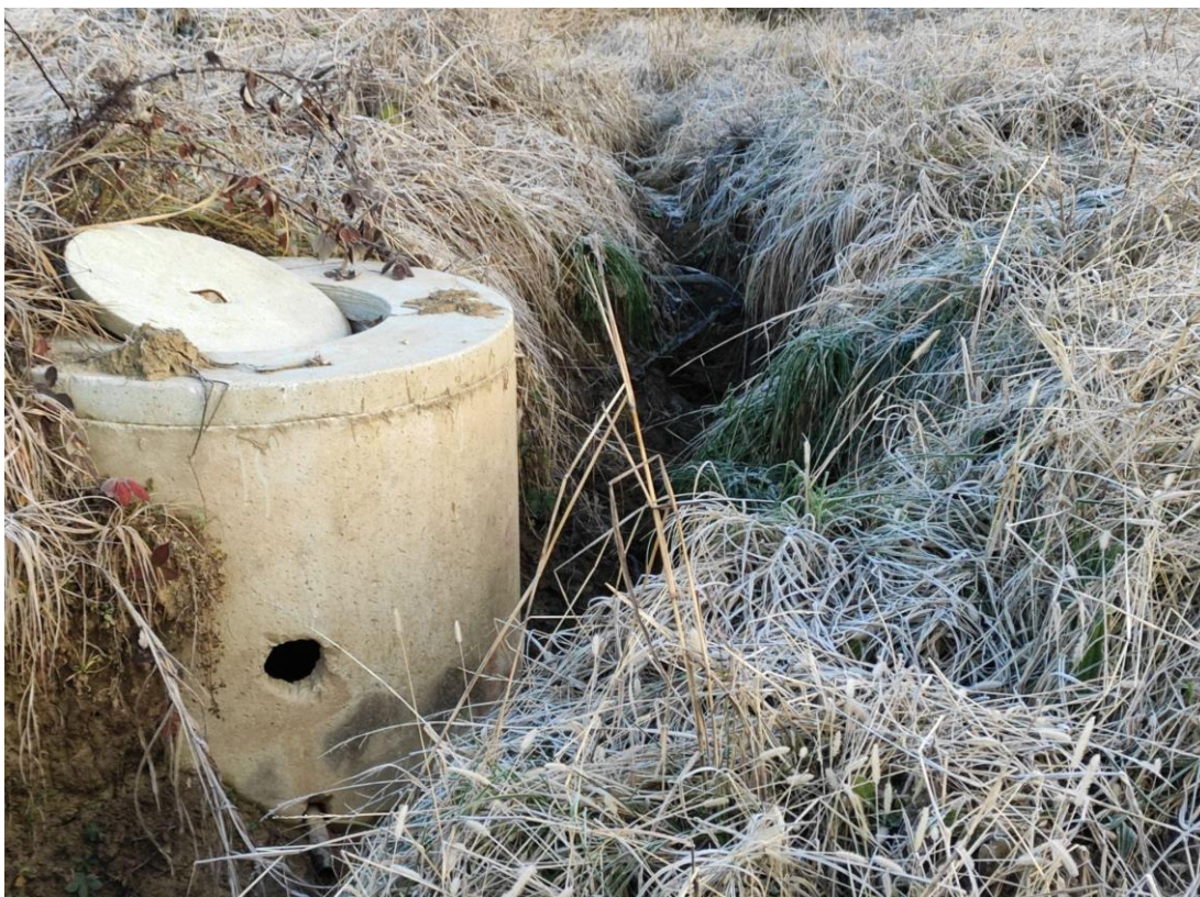
Fotografija 21: Kanal za odvodnjavanje, zbirnik vode na plazu, foto: Klara Stajnko, 21. 12. 2023.
