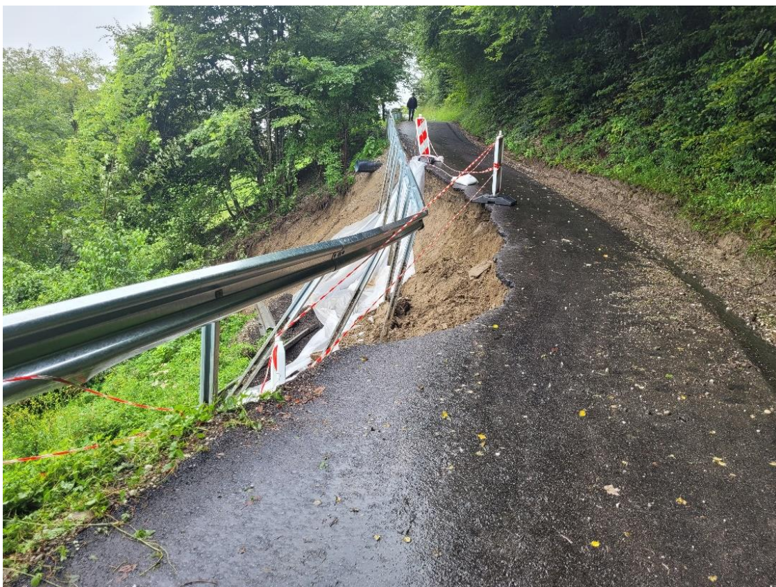
Fotografija 34: Odtrgan rob ceste do Šubernika na Vršniku, foto: občinska uprava Kungota, maj 2023.
