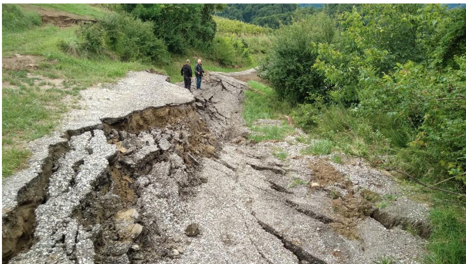
Fotografija 28: Usad je uničil cesto, Špičnik, občinska uprava Kungota, avgust 2023.
