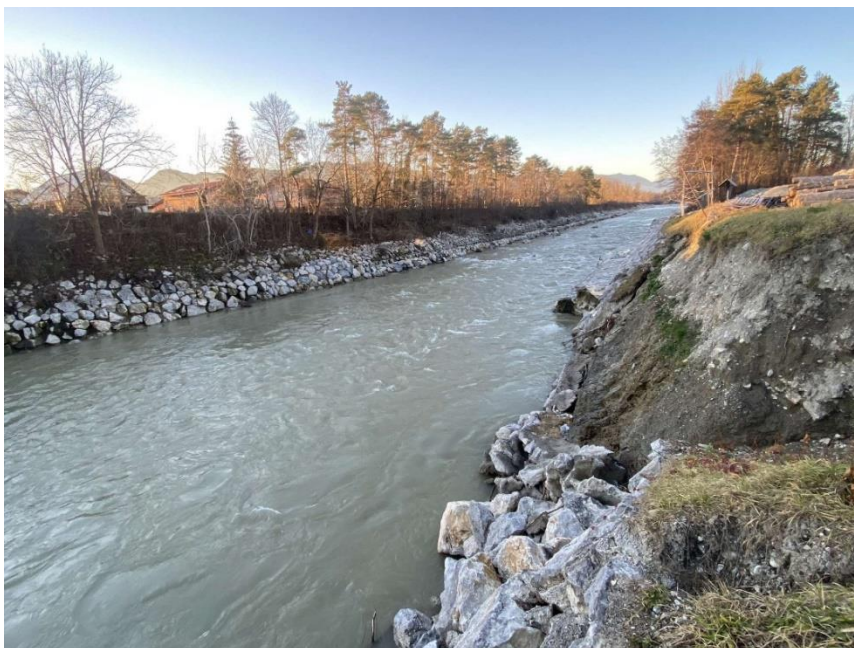
Slika 39: Uničene kamnite brežine nad Pariželjskim mostom (Lukman, 2024)
