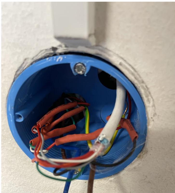
Slika 7: Izgled kablov ob končanem delu s spajanjem in krčenjem toplotne krčljive ovojnice (Vir: lasten)
