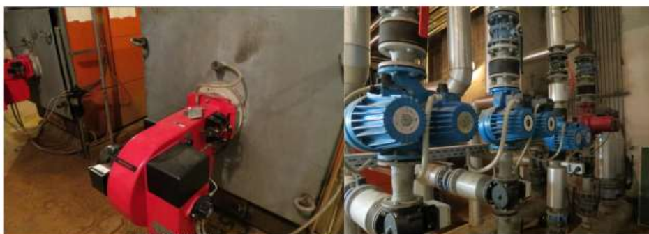
Slika 17: Kotla za ogrevanje na šoli Draga Kobala (vir: Razširjen energetski pregled osnovne šole Draga Kobala, Maribor)
