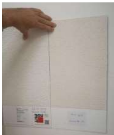
Slika 53: Odstopanje barve fasade (vir: dostopno na, https://we.tl/t-FKmrkKwQM_u , dne 5. 10. 2023)
