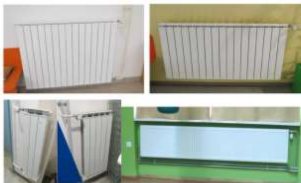
Slika 18: Primeri grelnih teles (vir: Razširjen energetski pregled osnovne šole Draga Kobala, Maribor)
