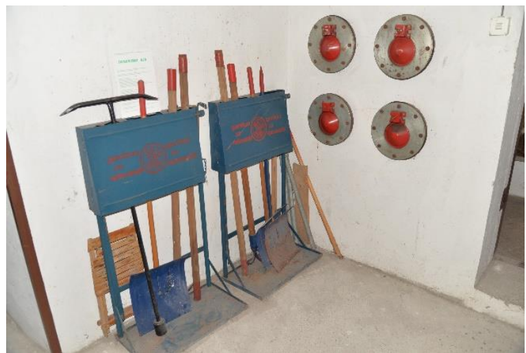
Slika 12: Osnovni komplet orodja za reševanje iz ruševin za zaklonišča in zračniki (blok, Kardeljeva ul.)
