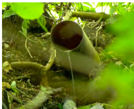
Slika 14: Odvajanje odpadnih voda pri spodnji postaji nihalke 2 (avtor: Iza Škrtič)
