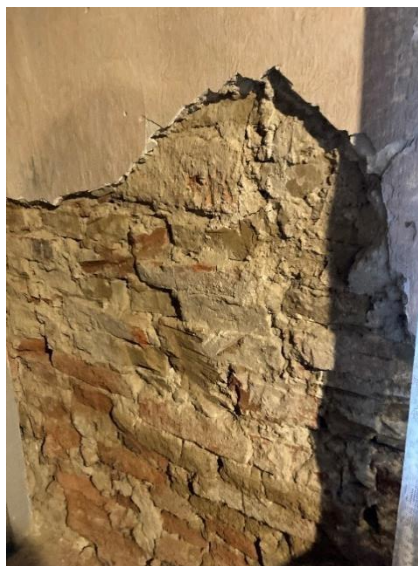
Slika 10: Odpadanje ometa na zunanji steni za vhodnimi vrati
