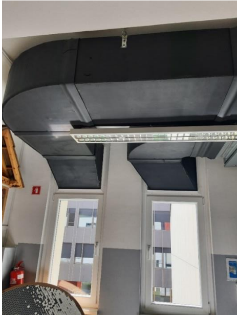
Slika 20: Prezračevalna naprava na gimnaziji Ravne na Koroškem
