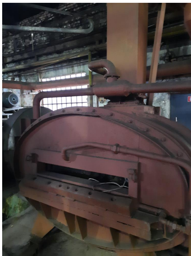
Slika 24: Elipsasata peč za segrevanje
